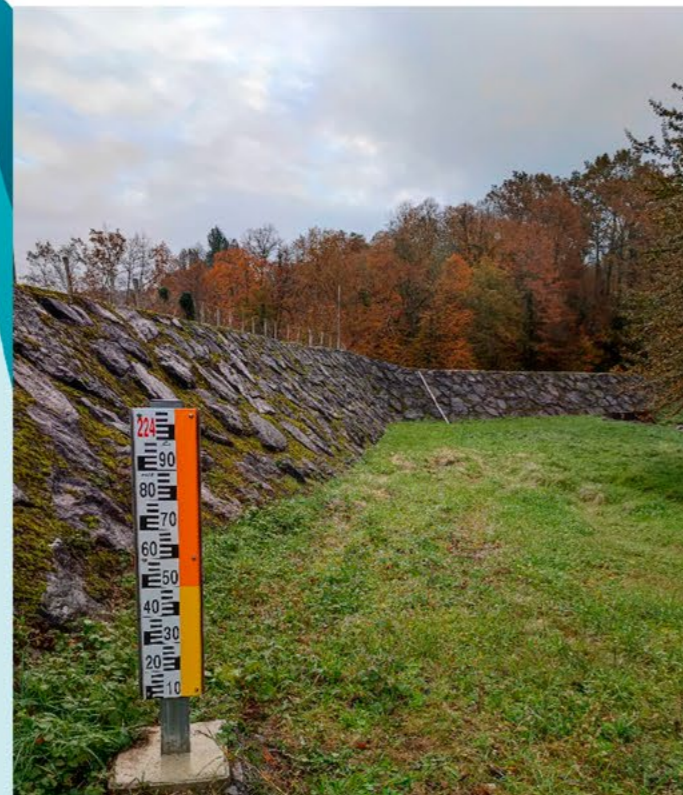
Echelle limnimétrique sur le barrage écrêteur de crues du Neez :
