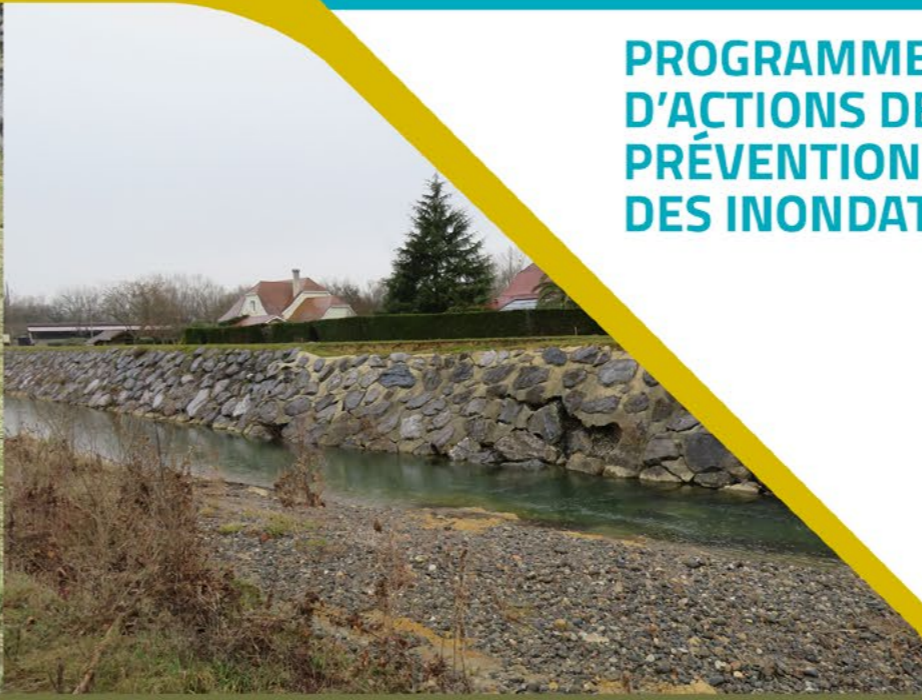
Affaissement digue Abidos
