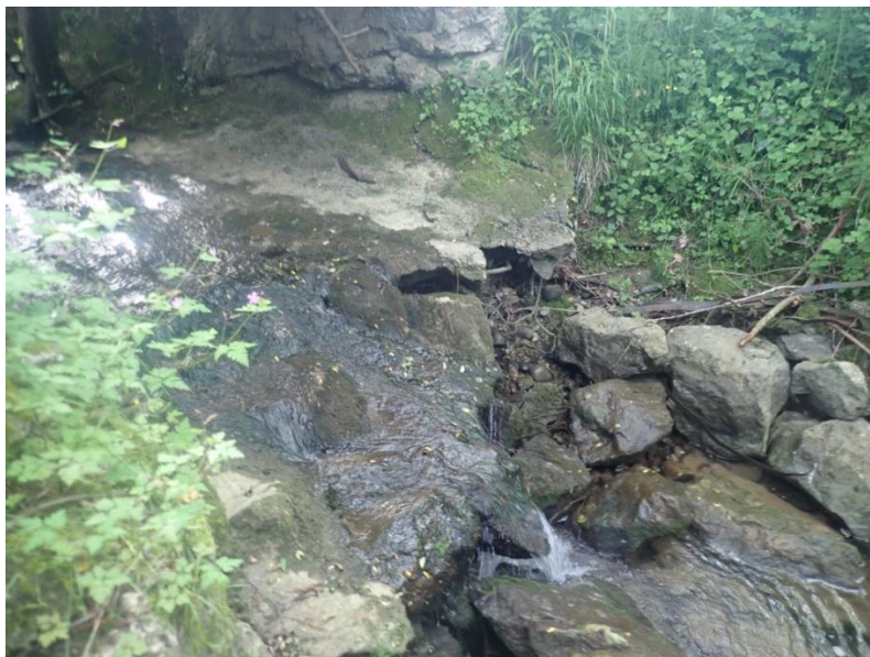
Radier du pont de Roquepine infranchissable (OH LO 03)
