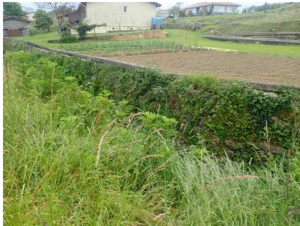
Protection de berges en pierre au niveau des habitations de Cauneille
