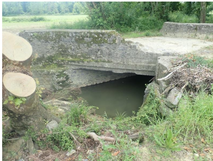
Berge dégradée au niveau du pont de la Nassette
