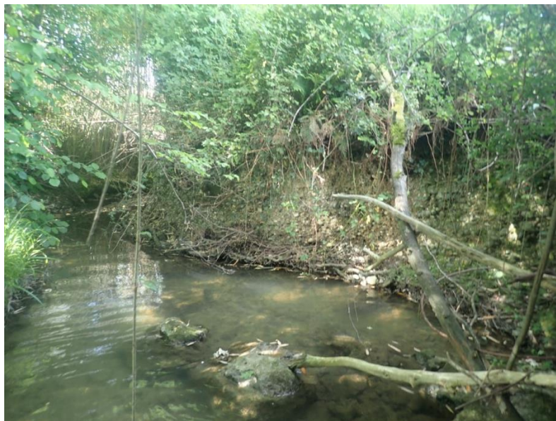
Erosion de berge à Bareille
