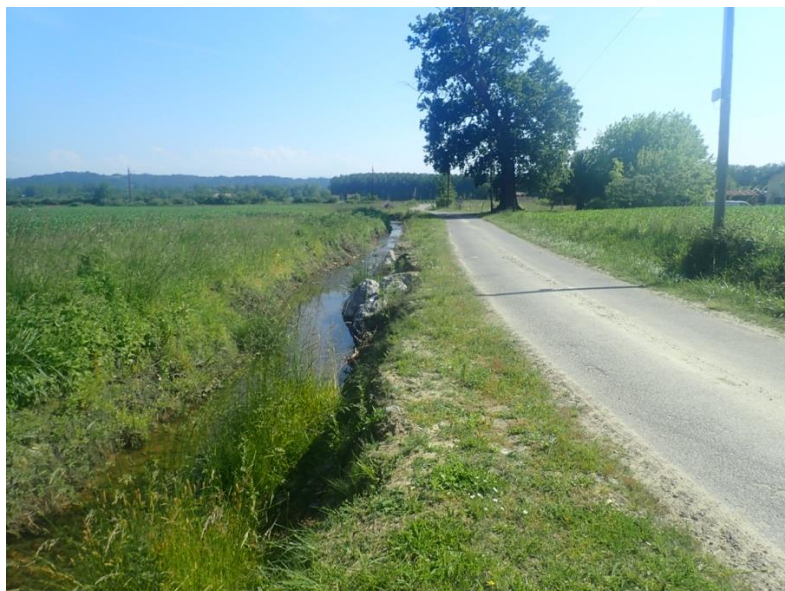
Berges dégradées et enrochements en bordure de route
