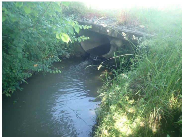
Passage busé infranchissable (OH PR 02)
