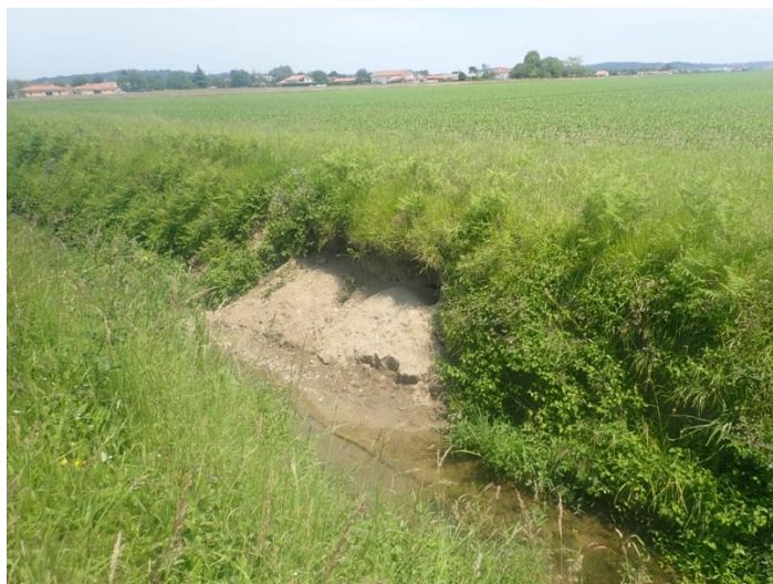
Berge effondrée au niveau d'un trou de ragondin
