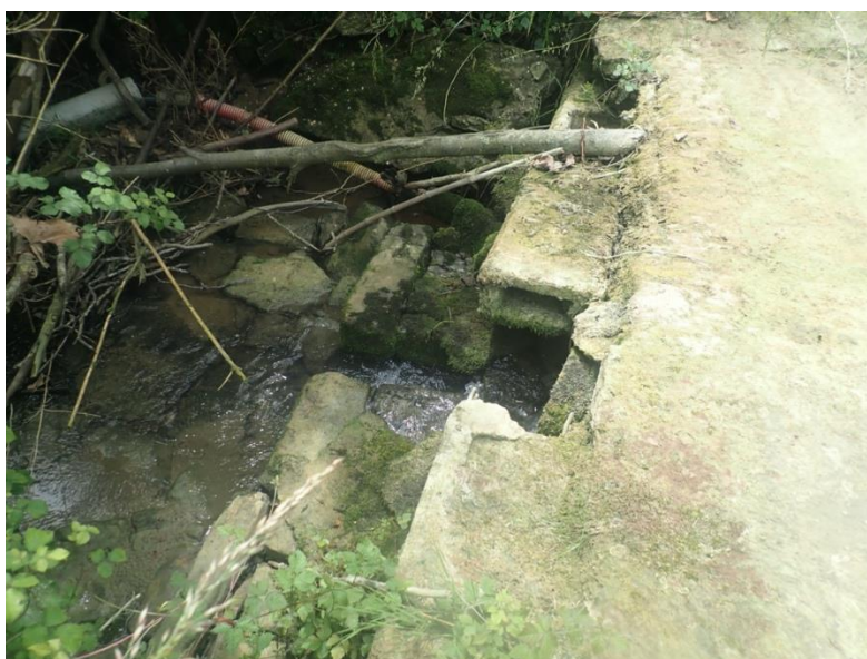
Passage à gué busé en aval du pont SNCF (OH CAU 04) bloquant la continuité écologique
