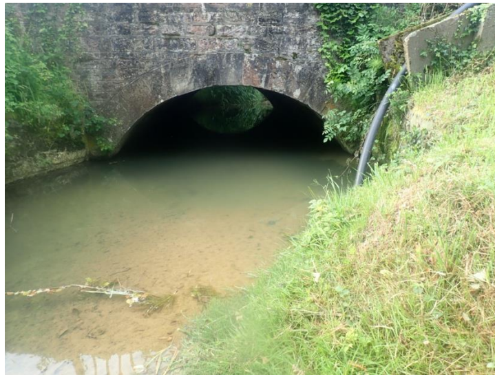
Atterrissement au niveau du pont SNCF
