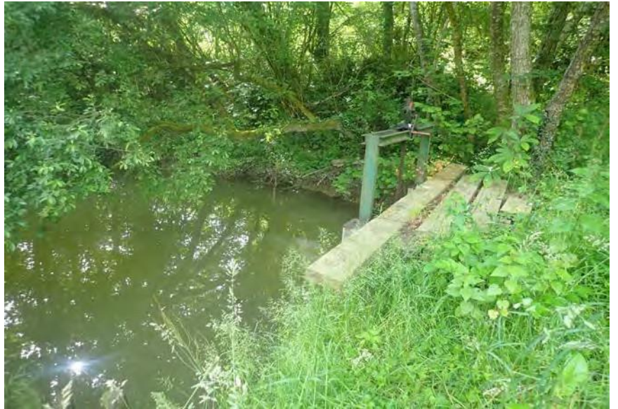
Vanne amont de prise d'eau du plan d'eau
