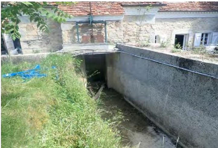
Vanne V2 du moulin
