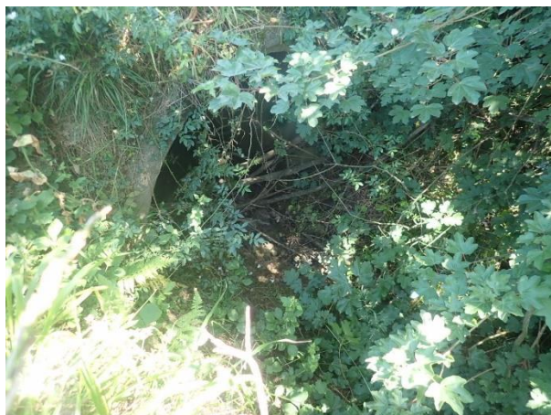
Buse légèrement obstruée par la végétation et quelques branches
