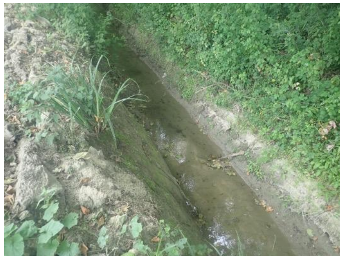
Figure 35 : Curage reprofilage et recalibrage dommageable sur le ruisseau de Peyrehorade
