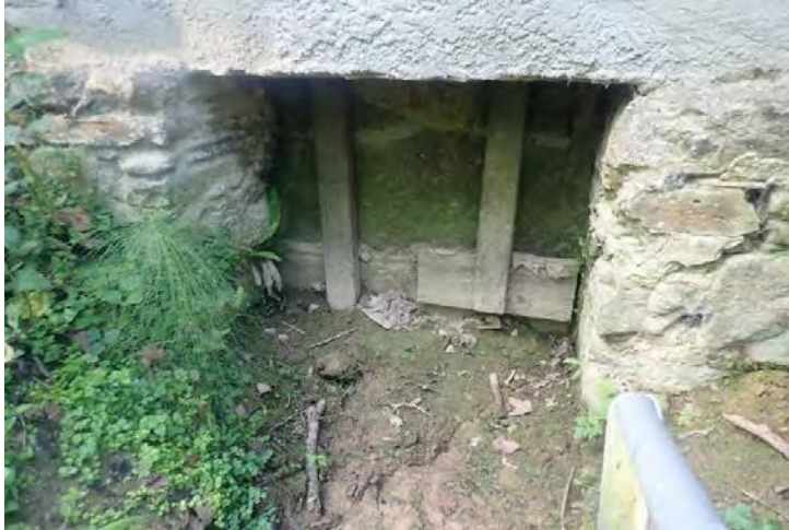
Vannes amont du passage comblé des turbines
