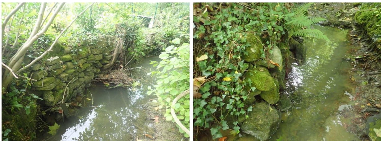
Protections de berges (mur en pierres et blocs) présentes en rive gauche au lieu-dit Laplacotte et à l'entrée de la prairie de fauche
