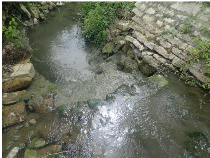
Seuil du pont de la voie SNCF bloquant la continuité écologique (OH PEY 08)
