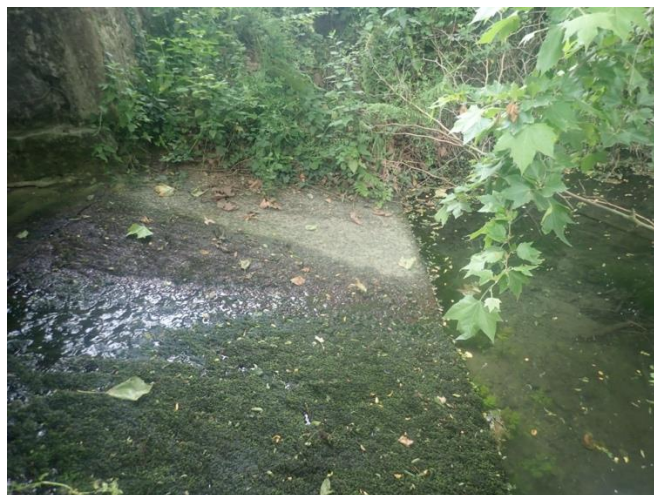
Ouvrage bloquant au niveau du franchissement de la D22 (OH PE 01)
