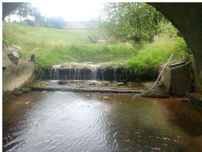
Seuil problématique au Pont de Peyre (OH MA 04)
