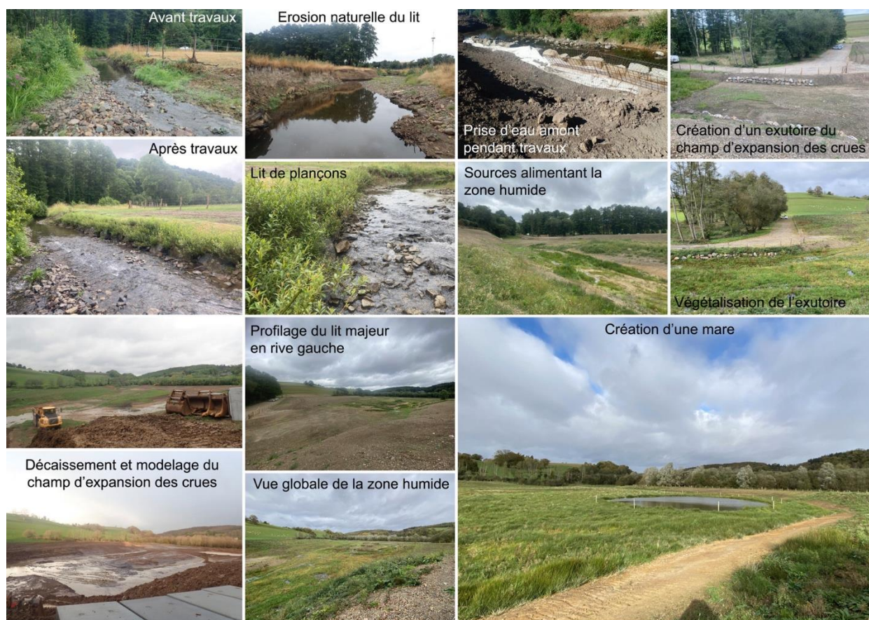
MOE CE3E mai-déc. 2020 – Gestion des écoulements de la Druance sur le site de l'ancien barrage de Pontécoulant – Condé-en-Normandie (14) – Travaux Lafosse&fils
