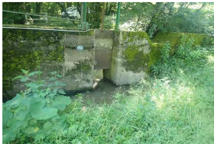
Ouvrages de décharge (vue amont) : Vanne + Déversoir
