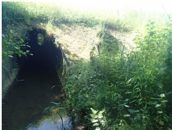
Les tunnels en tôle passant sous la D 430 à l'amont de la portion bétonné
