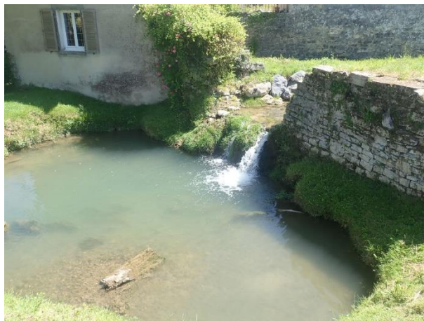
Seuil du moulin du lieu-dit le Bain (OH LABA 04) provoquant une chute importante
