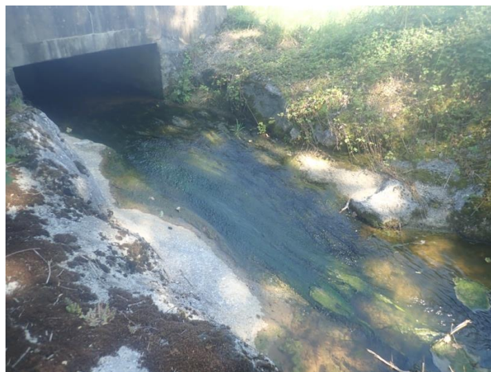
Radier du passage busé de Cuyon (OH GL 02)
