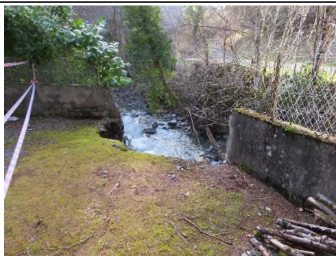
Conseil pour une restauration de berge adaptée à fort enjeu bati immédiat (enrochement partiel déjà fait sur ce point)
