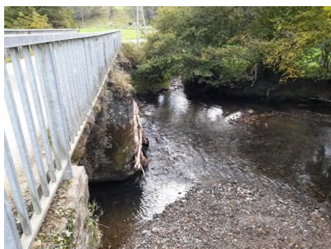
Embâcle sur ouvrage (Beez)
